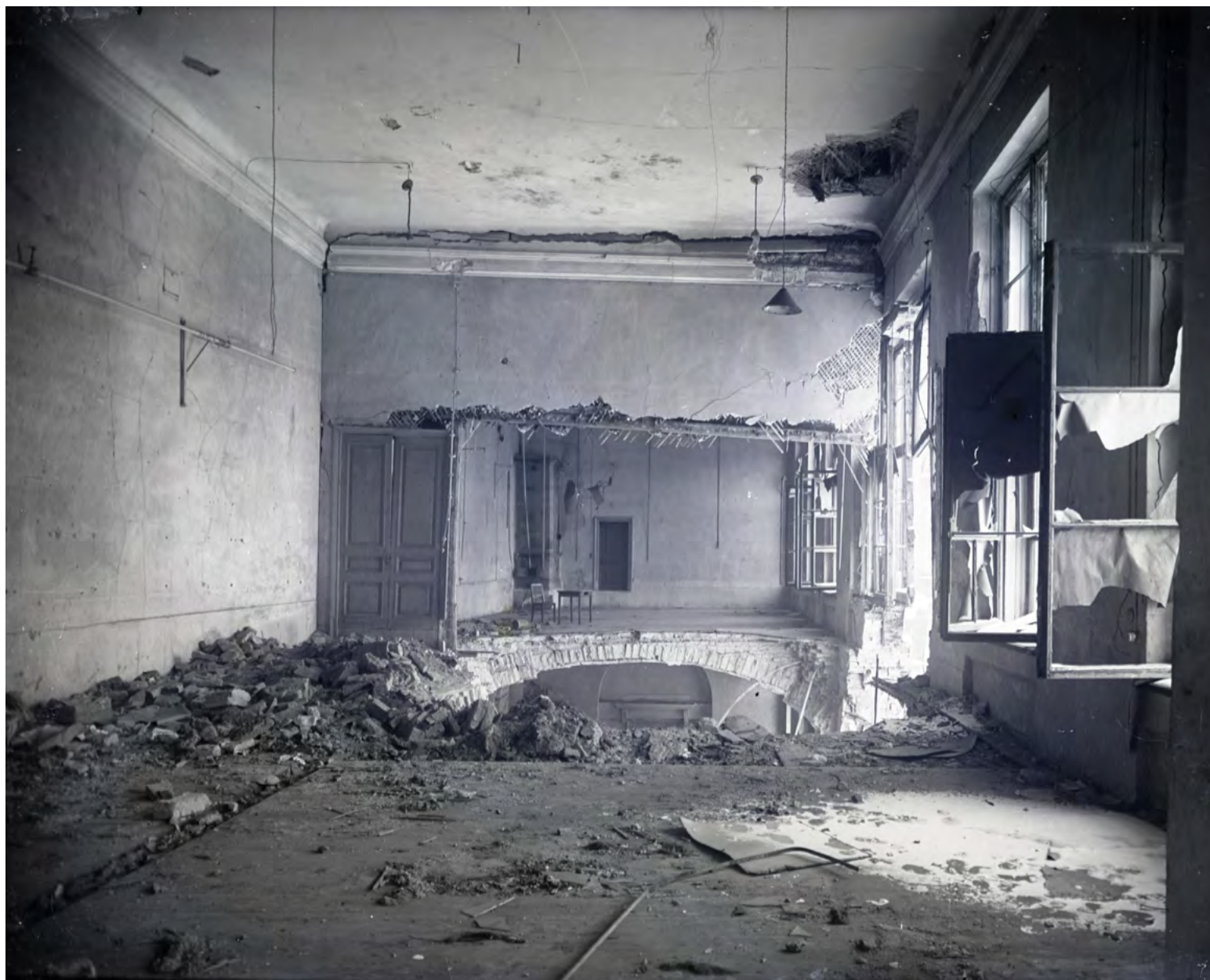
1. С.Г. Гасилов. Разрушения в главном здании Академии художеств после попадания снаряда.
